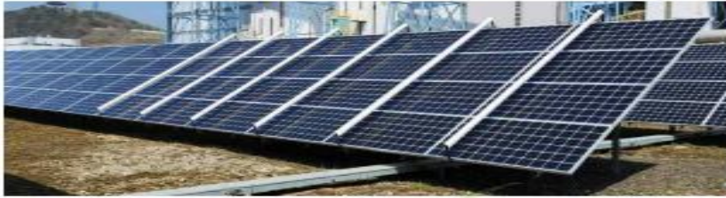
그림 음영 구조물 설치 후 태양광발전소
