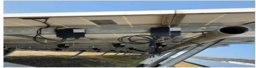
그림 전력용변환기 설치어레이 및 미설치어레이
